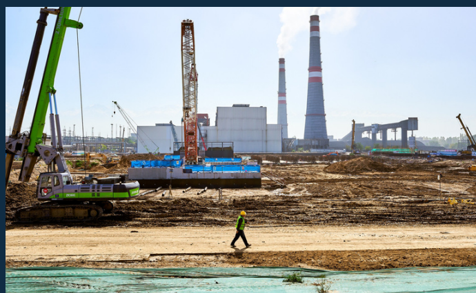
Centrale termoelettrica di Almaty 2. Credito fotografico: ADB in Kazakistan
